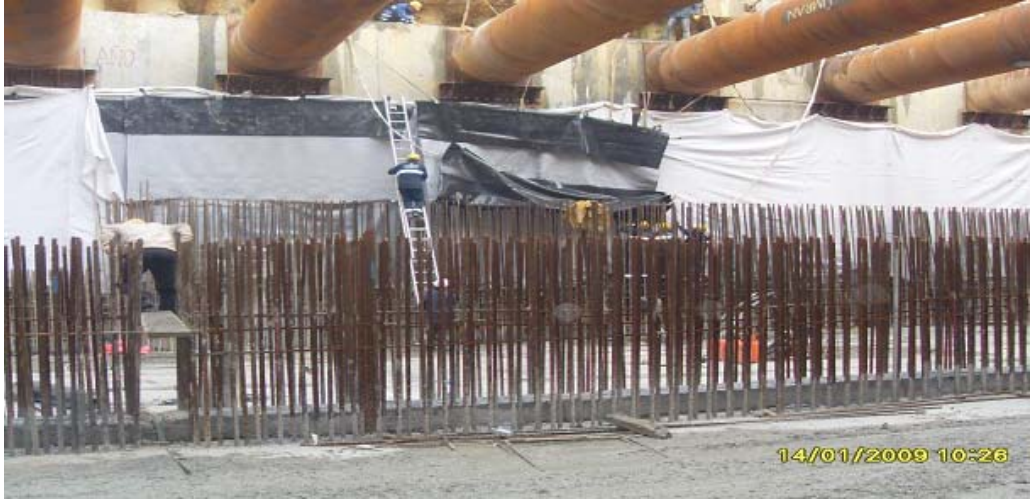
Resim 5. İstanbul Büyükşehir Belediyesi Güney sanayi metro istasyonu çelik dairesel iksaların hemen altından başlayan uygulama
